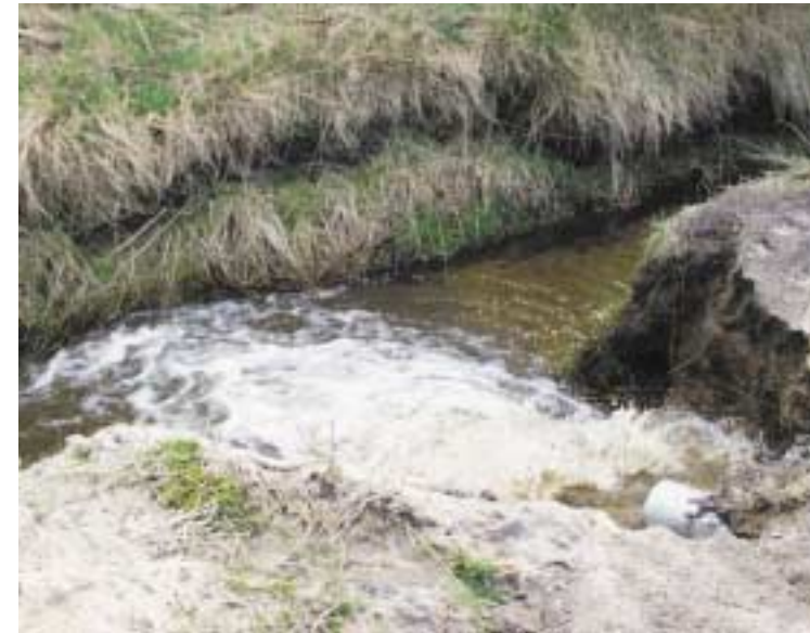
Dræn der har skyllet brinken væk
